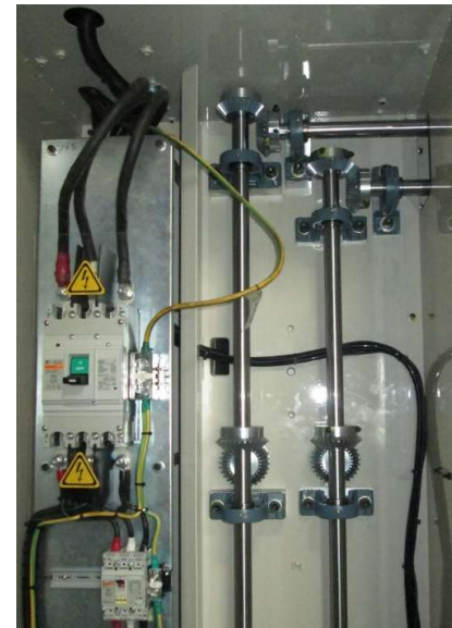
Electric Cabinet 電控箱
